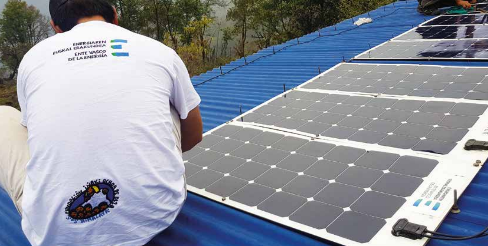
Instalazio fotovoltaikoa ospitaleko teilatuan.
